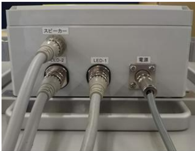
電源ケーブル、制御ケーブル
